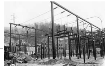
Un poste de transformation en 1939.
