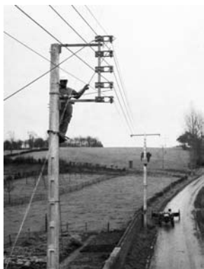
Contrôle sur une ligne basse tension, en 1970.
